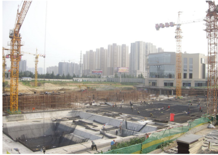
鑫琦国际广场6#楼A、B、C座基础钢筋正在绑扎,准备浇筑C座基础混凝土;C座以西地下车库墙及顶板模板安装,A座以南地下车库模板安装完成三分之一。
