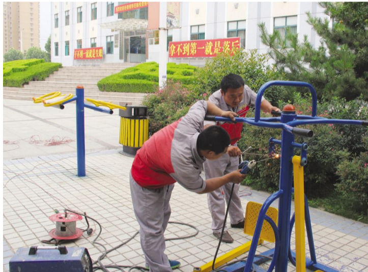
为提高小区居民文化健身生活,村在文化健身广场安装有健身器材,因器材长期暴露在外,部分器材出现螺丝松动,焊接裂缝现象,物业维修大队在例行检查时发现问题,及时进行了维修,保证居民健身安全。
