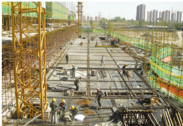
2#楼:地下防水及西侧部分车库底板混凝土;5#楼:西半部车库顶板已浇筑完成,东半部底板及顶板正在施工;6#楼:A座三层顶板已浇筑完成,B座及C座四层顶板已浇筑完成。 工程部
