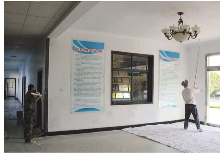
为美化办公环境,提升迎查接待水平,物业公司对办公楼墙壁、天花板、踢脚线进行了重新粉刷,粉刷后的办公室焕然一新,为大家营造了干净整洁良好的工作氛围,在此,号召所有员工爱护已有环境,维护整洁卫生。 物业公司
